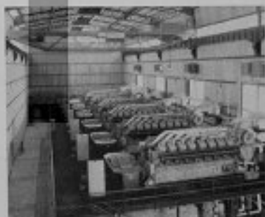
In copertina: Sala motori Diesel della Centrale ENEL di Trapani. La Centrale è impostata su sei motori FIAT a 4 tempi, tipo B 3016 ESS, a 12 cilindri di 300 mm di diametro, della potenza unitaria di 3360 Cv.
