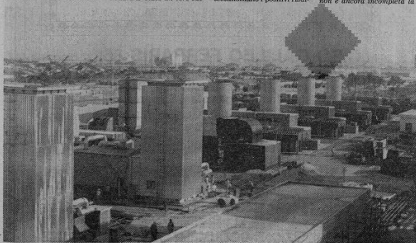
Emirati Arabi, Dubai: due turbine a gas TG 20 e quattro TG 16 per un totale di 140.000 kW installate dalla Dubai Electricity C
