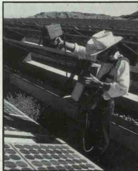
Controllo pannelli fotovoltaici.
