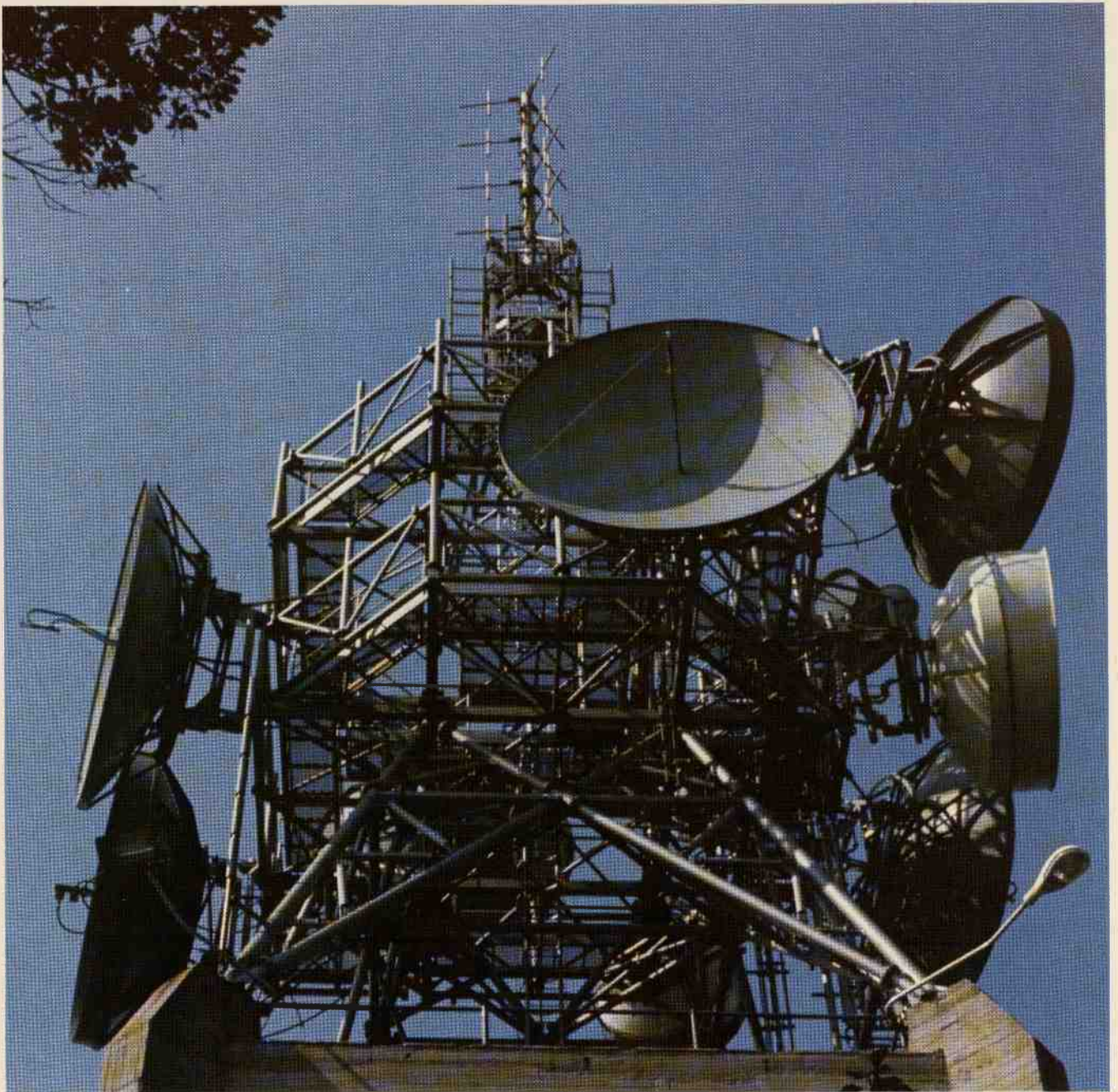
Sip - Bologna - Traliccio Centro Radio
