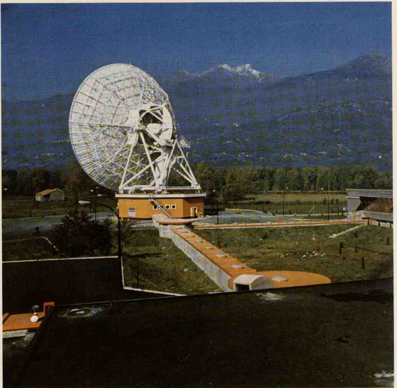
Telespazio - Stazione del Lario - Antenna - La stazione ospita anche un complesso antenna per gli esperimenti con il satellite Sirio
